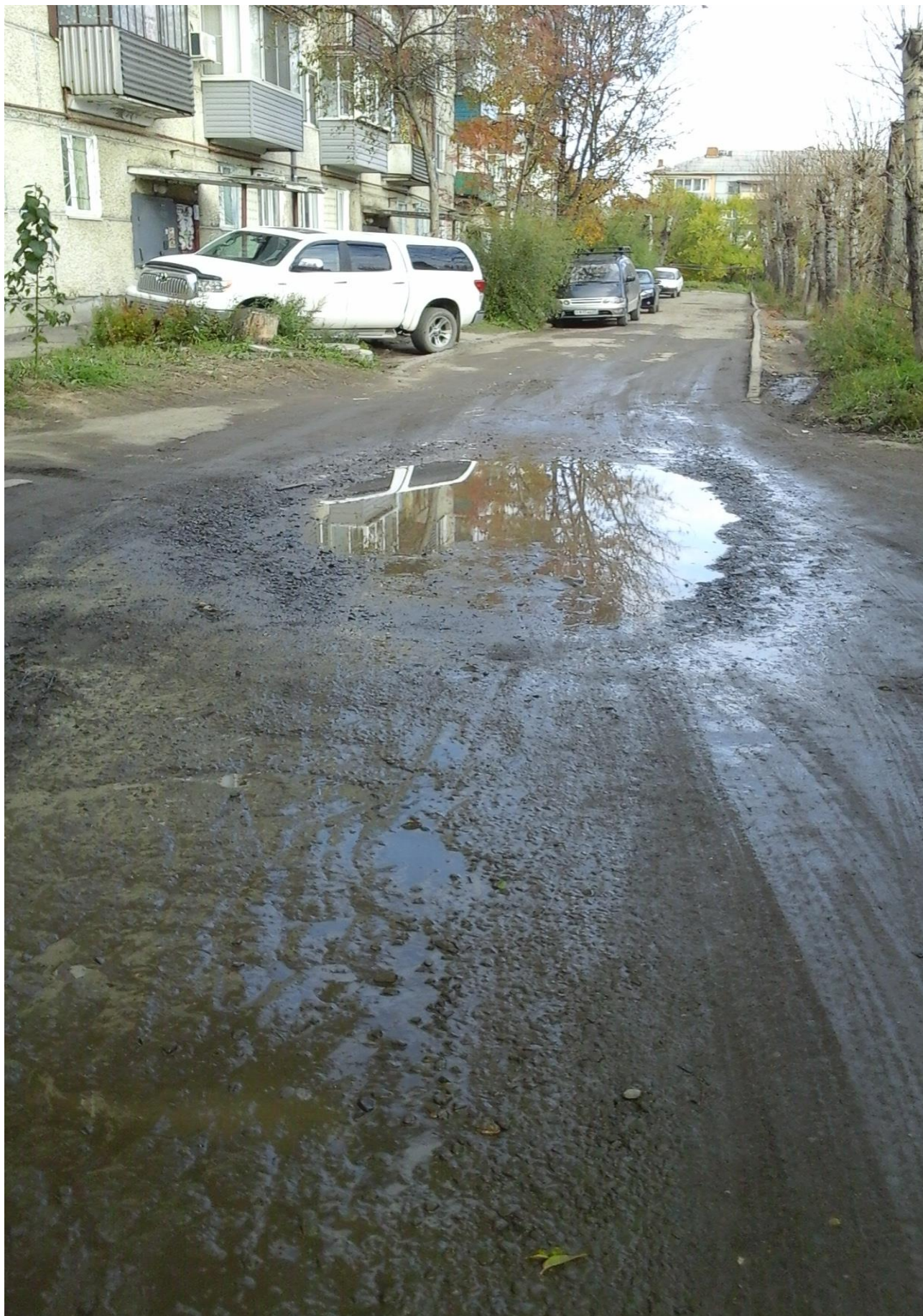
Дворовая территория до ремонта:
